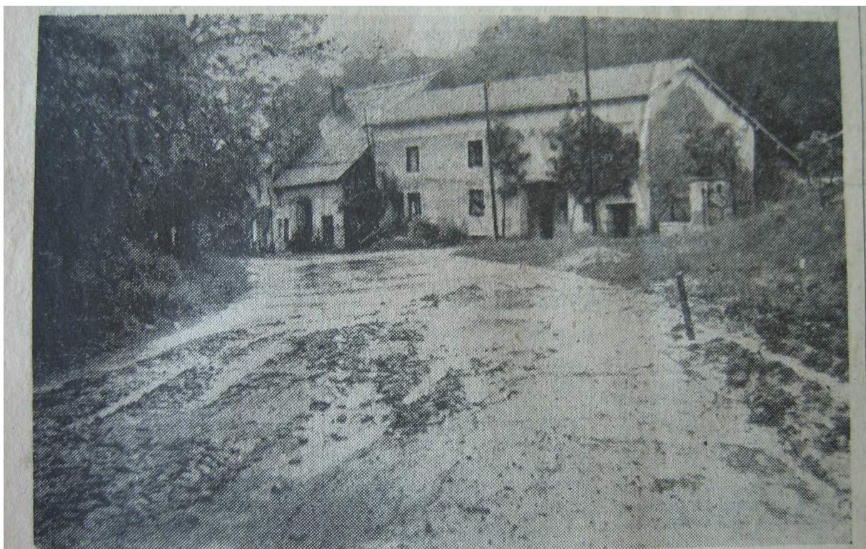
La route nationale 830 défoncée à Médière
