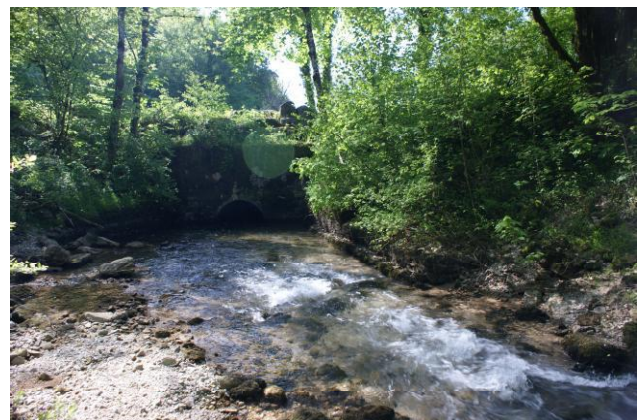
Figure 11 : vue amont de la buse infranchissable présente à l'amont de la confluence entre le ruisseau du moulin et le lac de Chalain. Cliché : Serge Regad
