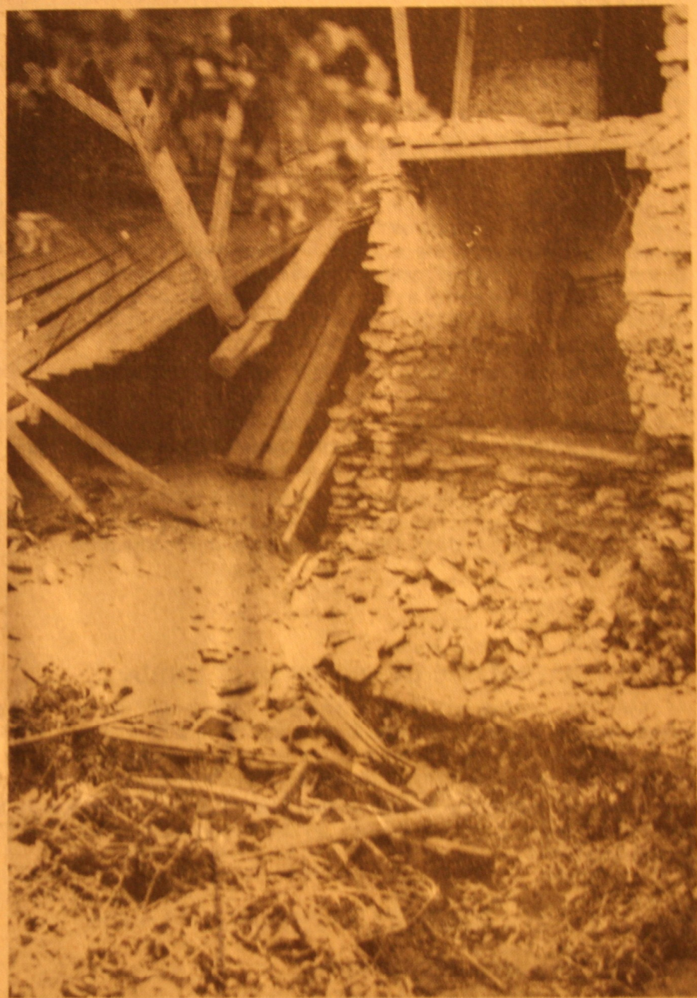
Le mur de derrière de l'hôtel du Val d'Or complètement effondré.
