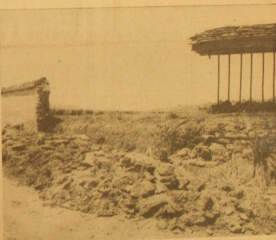
Au clos des Epeaux, le mur a été emporté par la violence des flots
