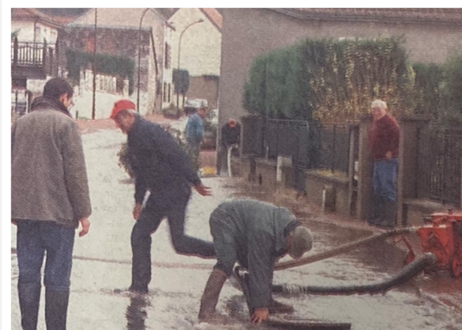
La route départementale 9 inondée par l'Ouche au niveau de la commune de Plombières-lès-Dijon (Bien public, Archives départementales de Côte-d'Or)
