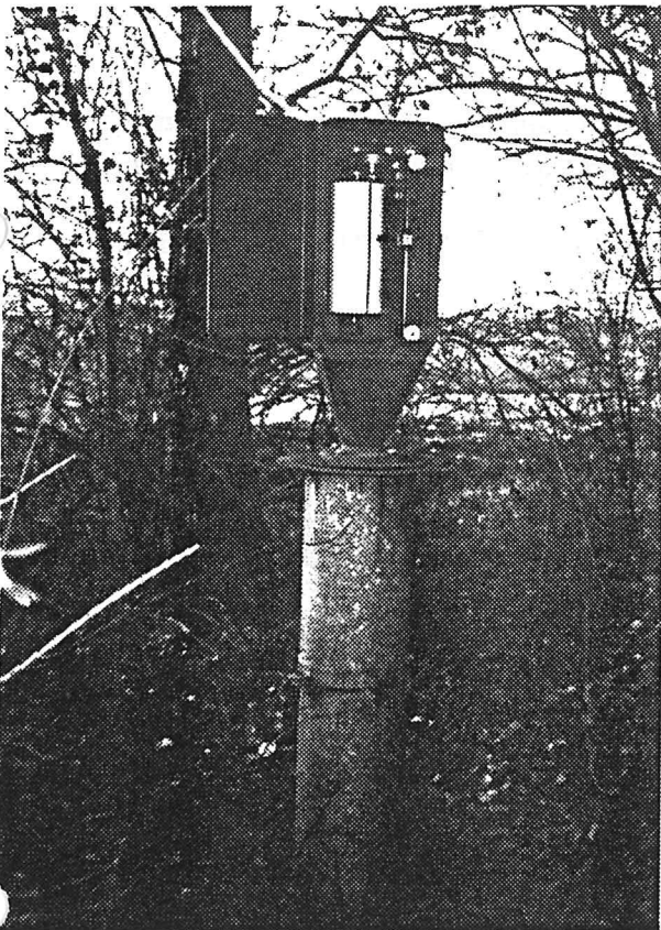
Piézomètre de Spoy sur la nappe alluviale de la Tille
