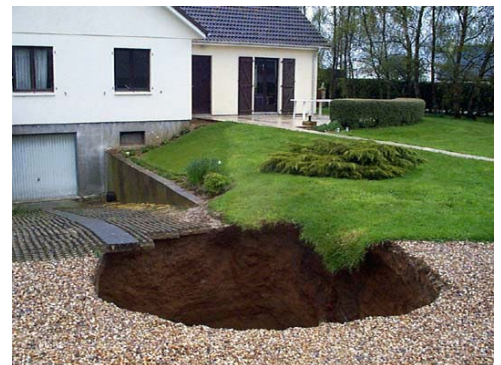
Figure 1 : effondrement de cavité présentant un risque pour les biens et les personnes (Cerema, 2001).
