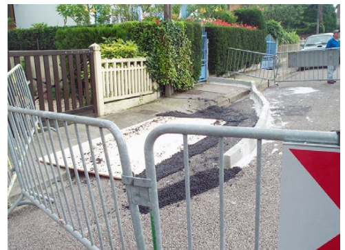
Figure 3 : comblement d'urgence d'un effondrement ayant affecté une voie communale (Cerema, 2003).
