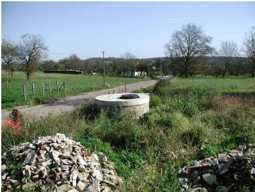
Illustration 12 – Effondrement tubé et aménagé en exutoire pour eaux pluviales sur la commune Oiselay-et-Grachaux
