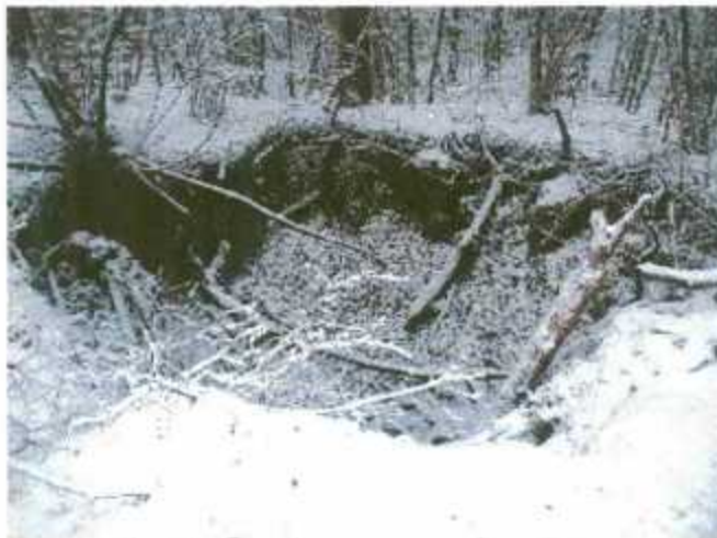
Fig. 10. - Ancien fontis survenu dans une zone boisée (diamètre inférieur à 10 m), secteur de Champvans-les-Moulins
