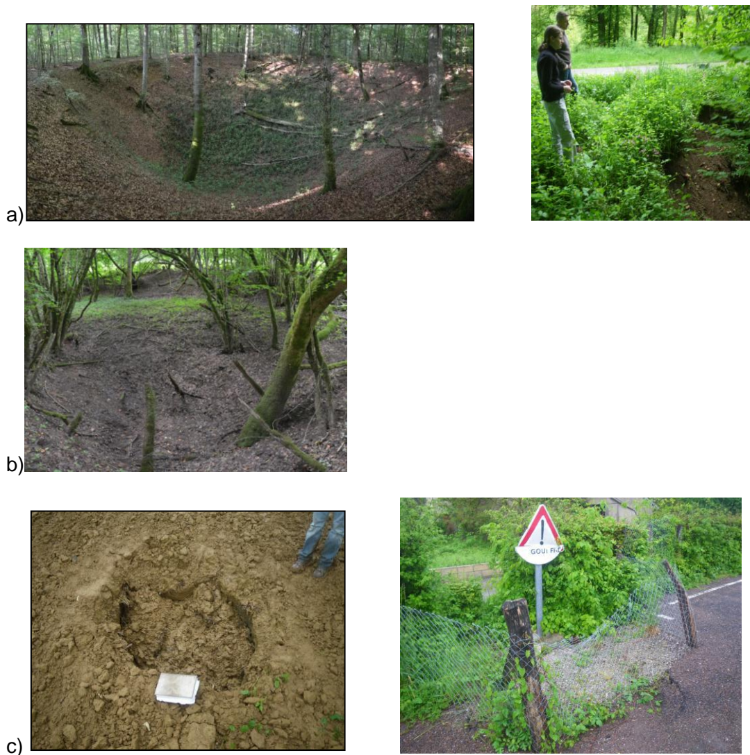
Figure 80 : Illustrations des différents types de désordres observés en Franche-Comté : a) doline fermée de grandes dimensions, Montboillon, Haute-Saône à gauche et doline fermée à soutirage très actif en bordure d'une route départementale, Dép. du Doubs à droite b) doline perte en Haute-Saône c) fontis récent dans un champ (Chaucenne, Doubs) à gauche et fontis en bordure de la chaussée sur la commune de Bonnevent-Veloreille (Haute-Saône) à droite
