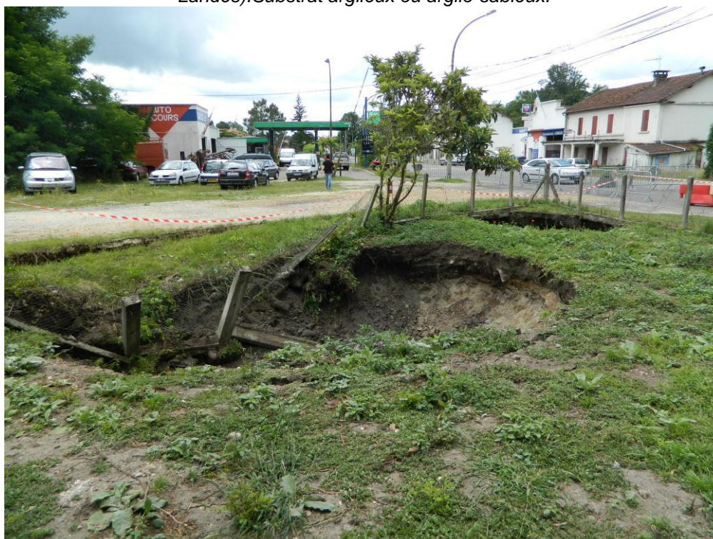
Figure 64 : Deux fontis alignés selon une direction E-W, apparus sur l'avenue Gaston Lescouzeres en 2012 à Roquefort (département des Landes)
