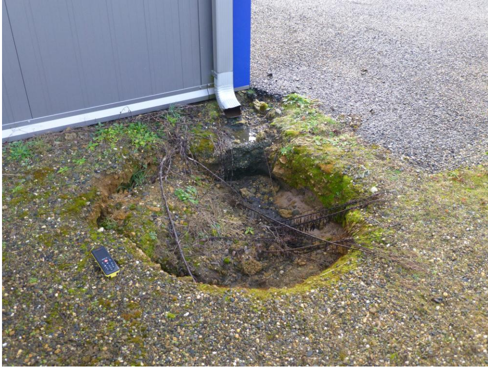
Figure 65 : Fontis de petite taille au droit d'une gouttière (Roquefort, département des Landes)
