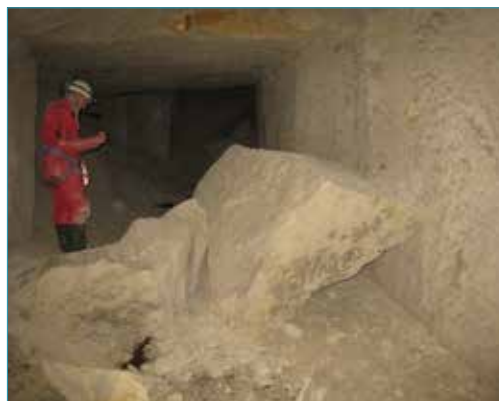
Illustration 1.10 : Chute de blocs dans une carrière souterraine, Sarcé (72) [crédit Cerema Ouest, 2012]
