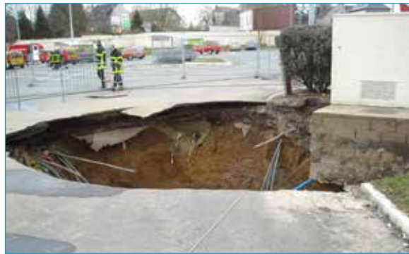
Illustration 1.27 : Effondrement de chaussée, Bapaume (62) [crédit BRGM, sd]
