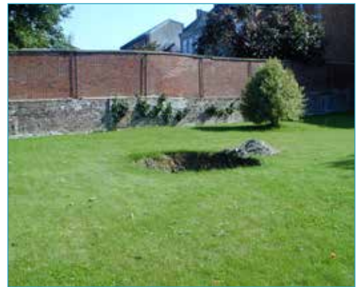
Illustration 1.24 : Effondrement non protégé dans un jardin en Somme [crédit INERIS, sd]
