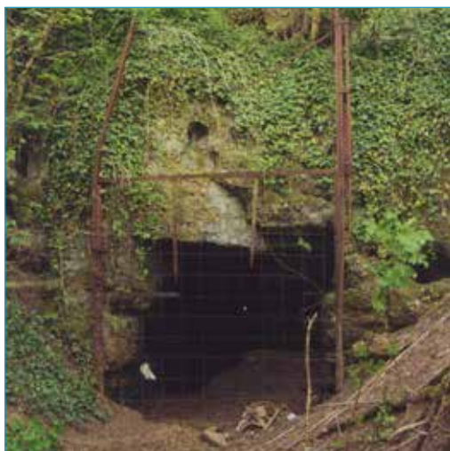
Illustration 3.10 : Accès mal fermé d'une cavité, Doubs [crédit INERIS, 2001]
