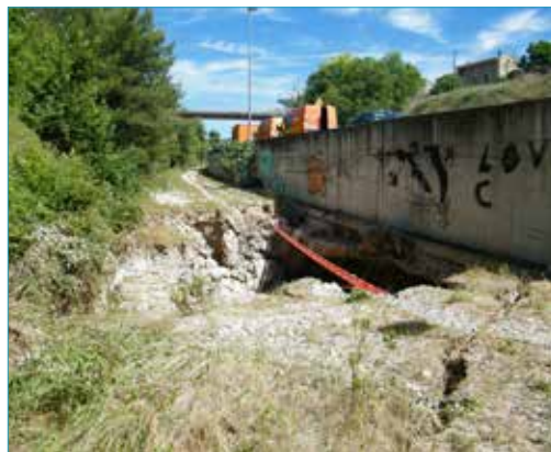
Illustration 1.16 : Fontis (cavité naturelle), Trans-en-Provence (83) [crédit Cerema Méditerranée, 2010]
