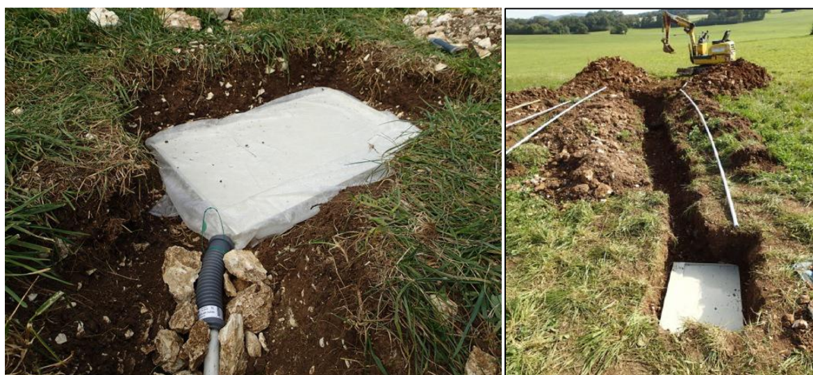
Figure 7. Plaque lysimétrique en cours d'installation dans un sol très superficiel. Clichés É. Lucot.
