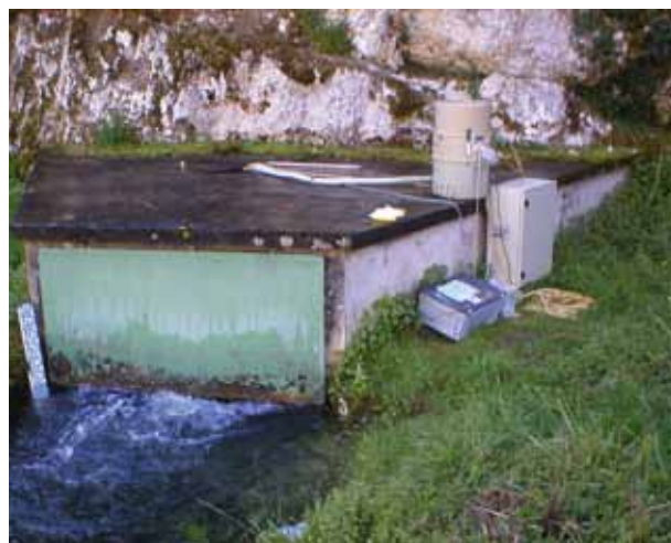
Captage de la source du Bournac (Lot) Captage de type A - Photo GINGER
