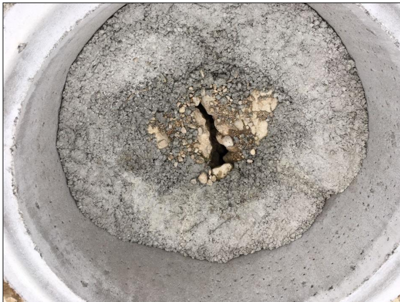
Photos 3 : Détail de la diaclase en fond de buse MAISON DU BOIS le 17/09/2018
