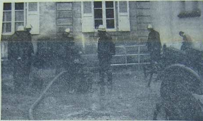
A LONS : les pompiers vident le sous-sol de l'hôpital
