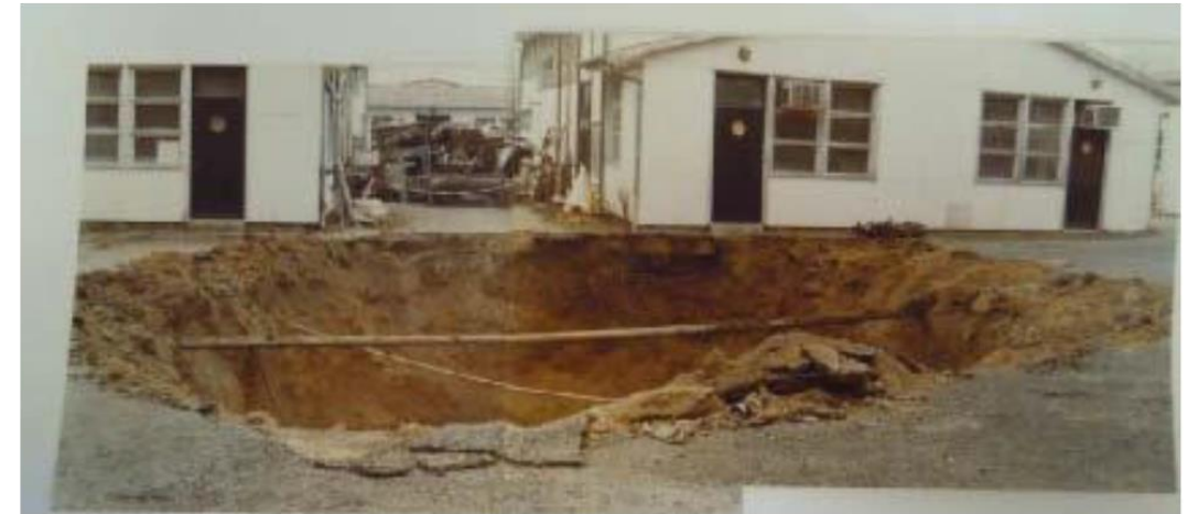
1986 - Effondrement à l'Université : diamètre \approx 10 m, profondeur \approx 3-4 m.
