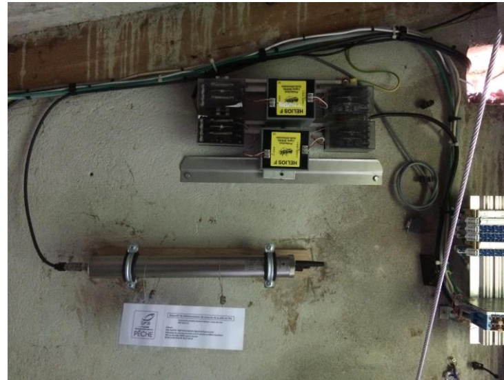
Modem installé dans un abri hydrométrique
