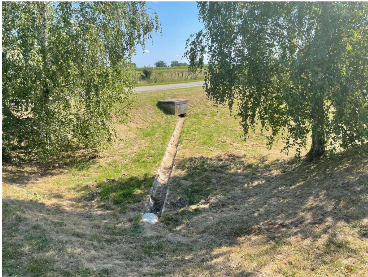
Illustration 32: Exemple de petit bassin d'orage construit lors de l'aménagement d'un lotissement sur la commune de Bâgé la Ville (juillet 2022)
